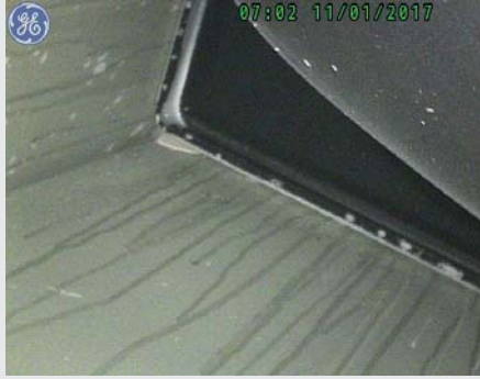
↑ Wasseraustritt unterhalb einer Duschtasse (früh erkannt)
