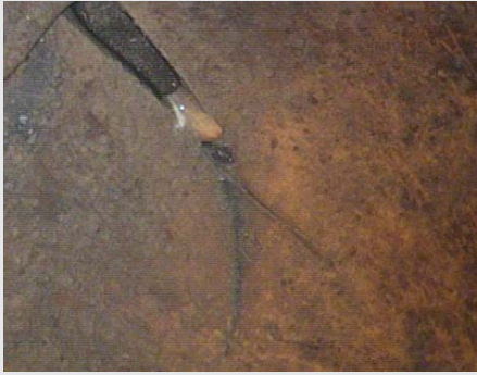
↑ Bruchstelle im Gussrohr
