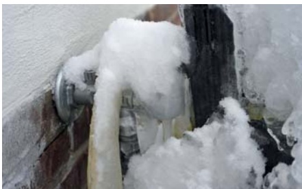
↑ Vereister Wasseranschluss: Zuleitungen zu Wasserhähnen im Außenbereich müssen abgesperrt und entleert werden.
